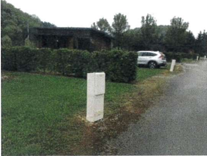
Coffrets électriques non protégés
