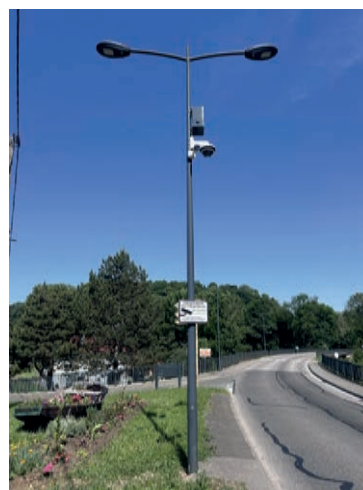
Système de vidéoprotection quai du Canal à Baume les Dames
